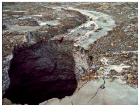
Рис. 2. Карстовый провал на автомобильной дороге (Ивано-Франковская область).
